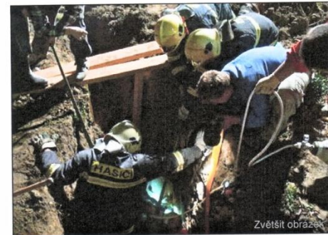
Hasiči se snaží vyprostit muže zavaleného ve výkopu.
