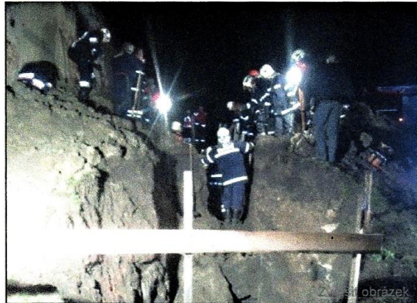
Hasiči prohledávají v Chotěšově na Plzeňsku výkop, ve kterém byli zasypaní dva dělníci
